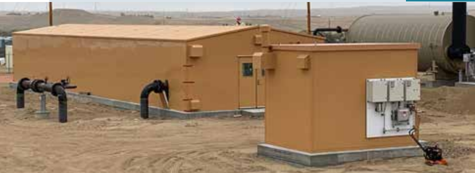
천연가스 배관 보호시설 / GRP 건물 Natural gas pipeline shelters / Buildings of GRP
