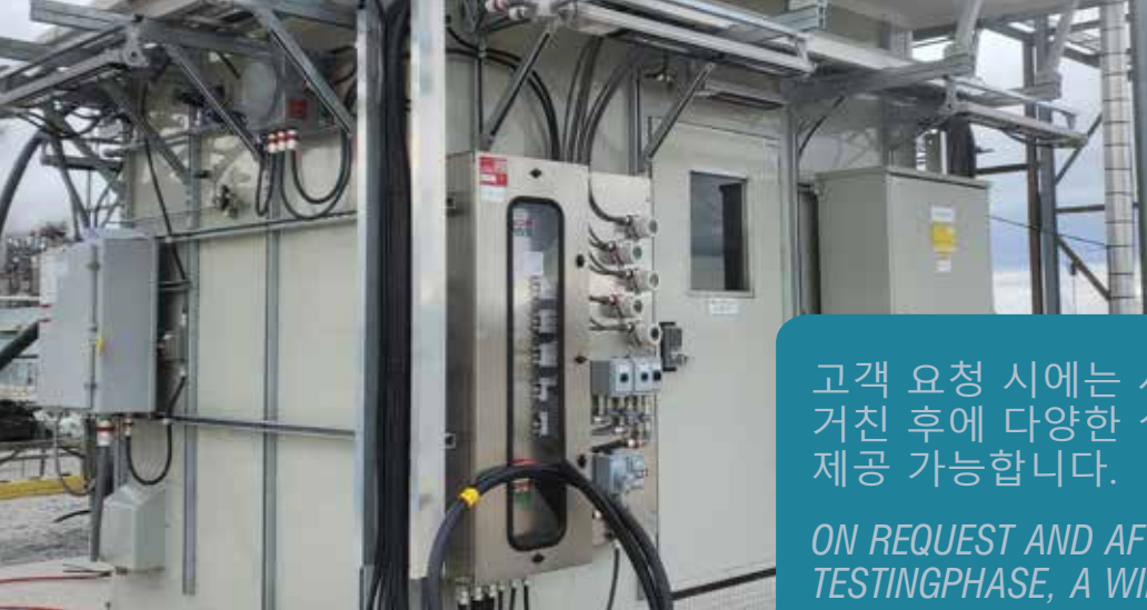
석유화학시설 내부에 섬유유리 패널로 만든 시험 분석 보호소 Analyzer shelters made with fiberglass panels inside a petrochemical facility
