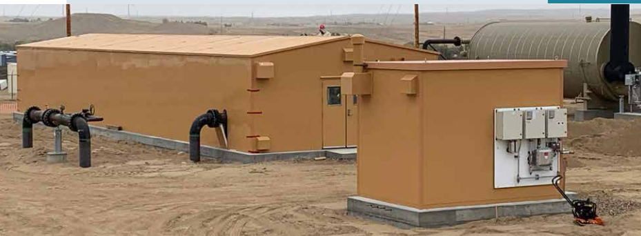
Cabanes en fibre de verre le long d'un gazoduc Glasfaserhütten entlang einer Erdgaspipeline
