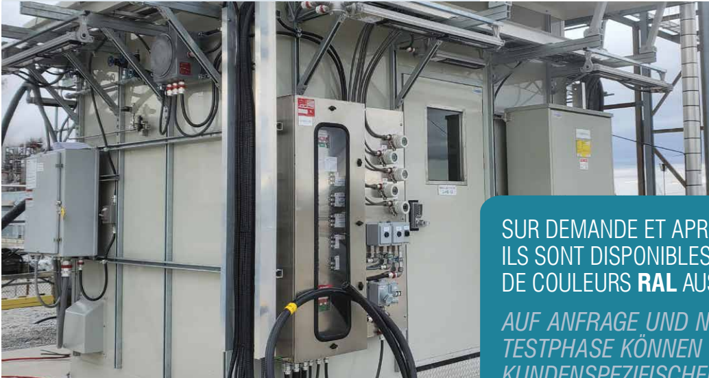
Station d'analyse en panneaux de fibre de verre à l'intérieur d'une usine pétrochimique Analysestation aus GFK-Paneele in einem petrochemischen Werk
